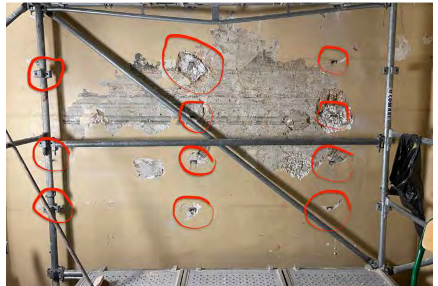
État lacunaire symptomatique du premier niveau. Paroi Ouest de la chapelle et les scellements au ciment dans l'enduit ancien.
