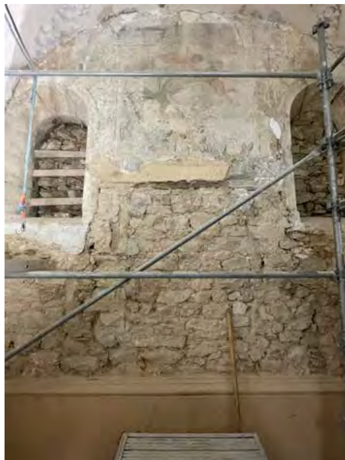
Piquetage de la voûte de la chapelle. Lacunes sur de grandes hauteurs des enduits anciens de la chapelle, paroi Sud.
