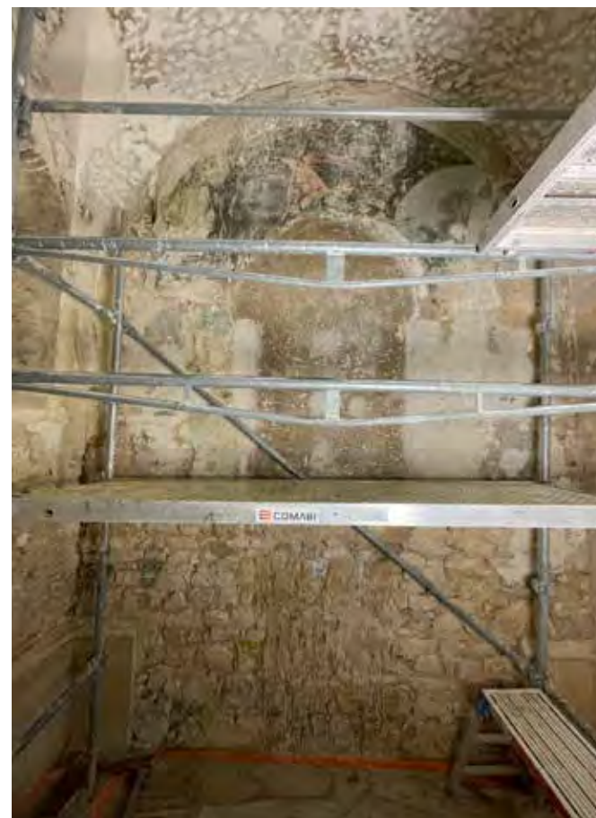
Lacunes sur de grandes hauteurs des enduits anciens de la chapelle et emplacement d'un autel et retable postérieur aux peintures, paroi Ouest.
