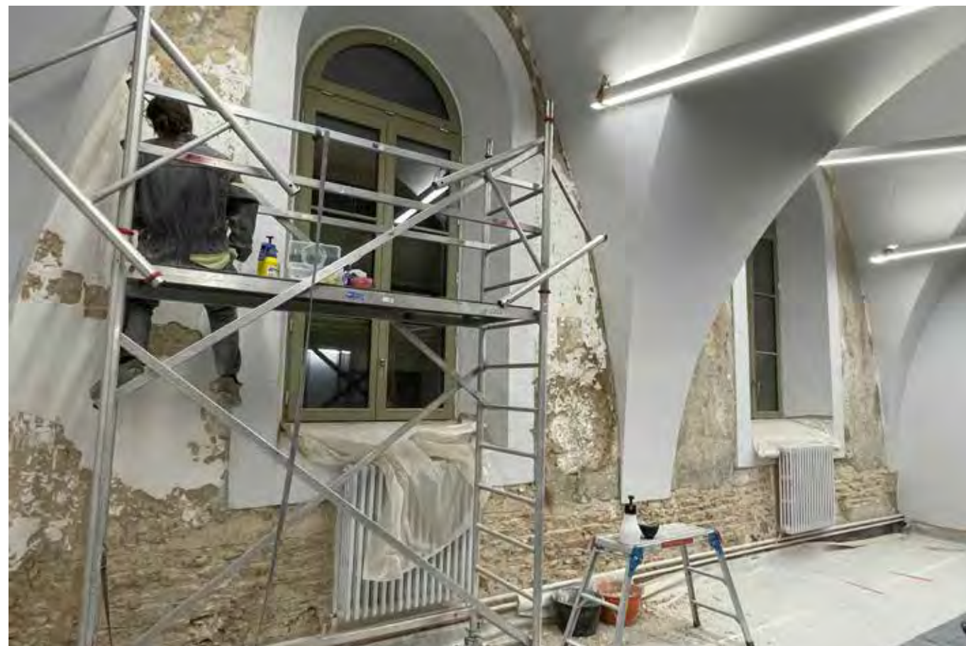
Pitons en métal déposés de la lunette de la première baie Sud. Zone d'arrachement de l'ancienne corniche laissant les voûtes flotter.
