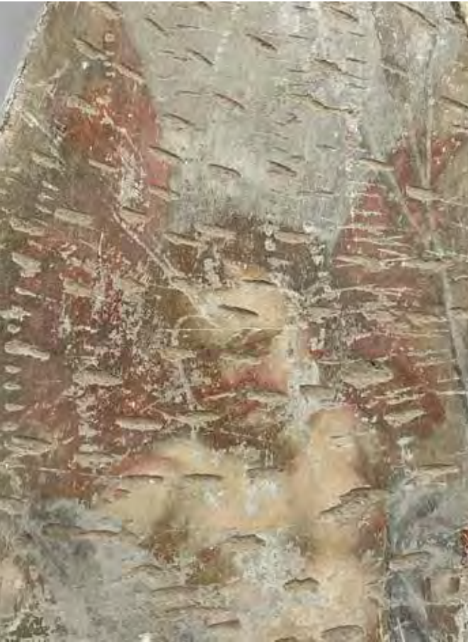
Escalier Est, voûte fermée dans le prolongement de l'ancienne nervure. Piquetages extrêmement serrés fragilisant les enduits.
