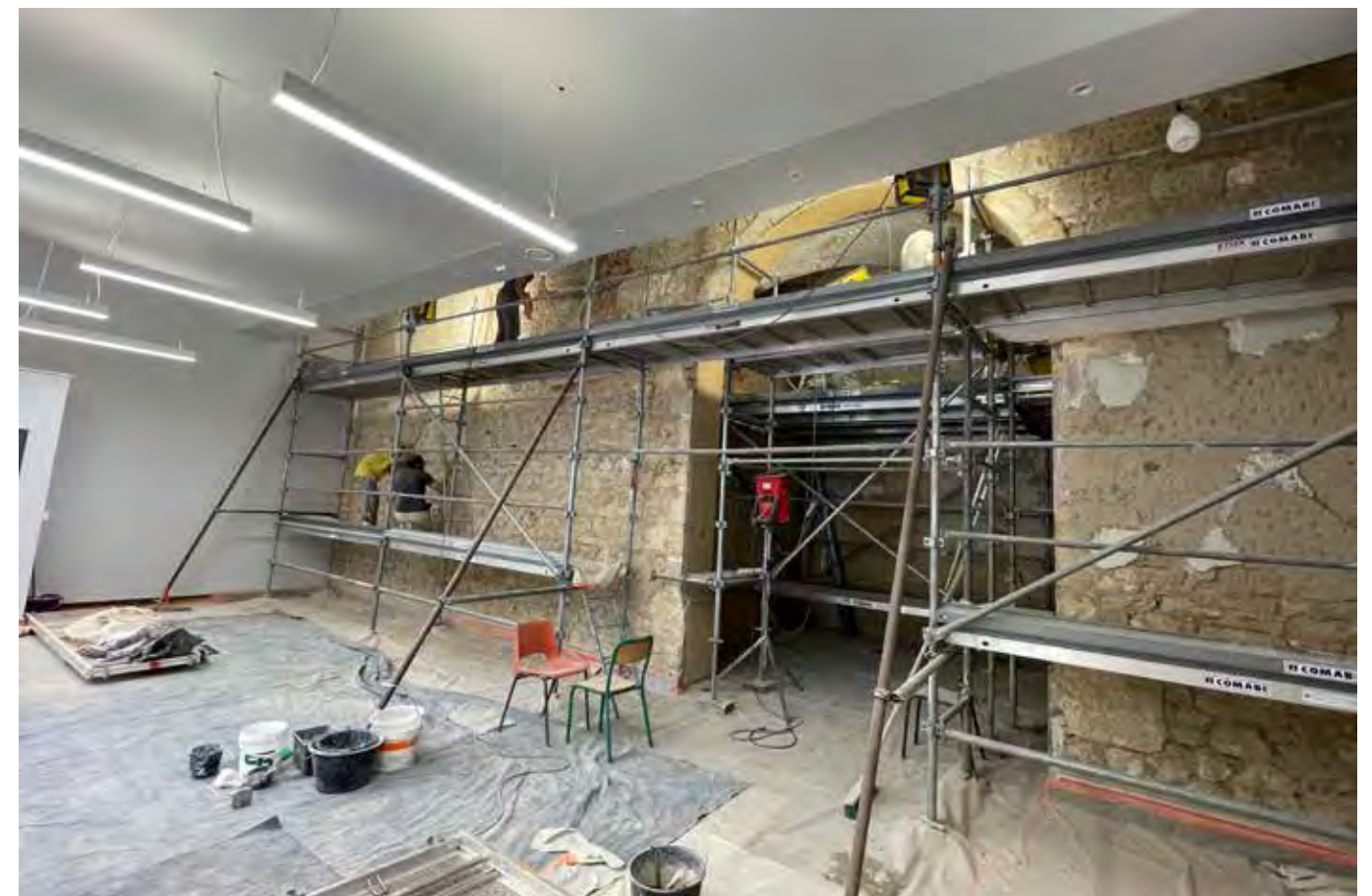
Piquetages extrêmement serrés fragilisant les enduits. État lacunaire de la paroi Sud au rez-de-chaussée.
