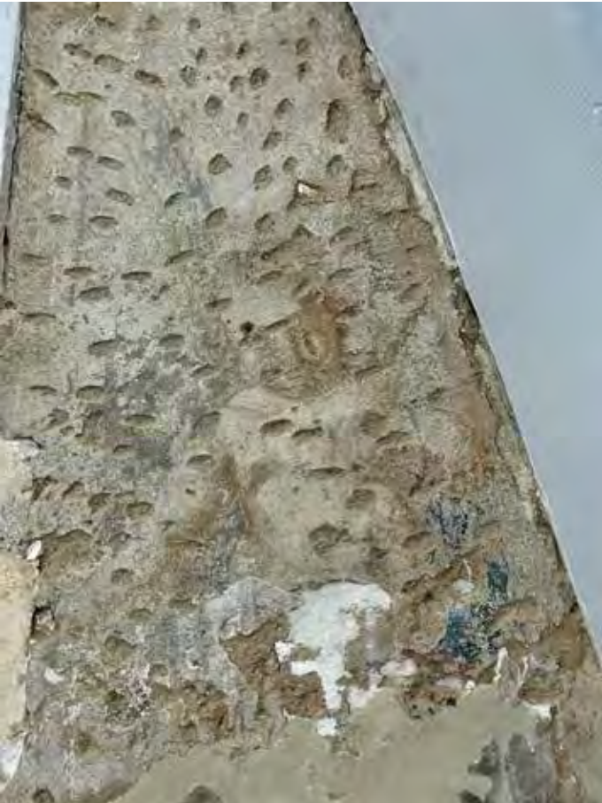
Encrage et scellement de plâtre. Piquetages extrêmement serrés fragilisant les enduits.
