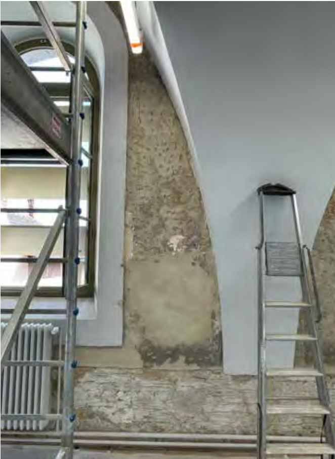
Griffures singulières dans l'enduit. Lacunes des nouveaux aménagements en bureau dans les années 1960.
