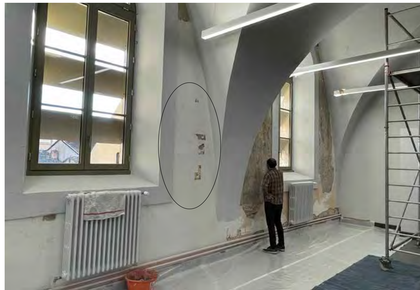
Dépôts de poussières noires pénétrant par les coups de sabre entre voûtes et parois du premier niveau. Deux zones où les décors ont été recouverts par une couche de peinture moderne (2021) pour permettre l'accroche d'enduits de rénovation.
