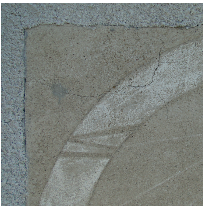
Fissures de l'enduit Juin 2021
