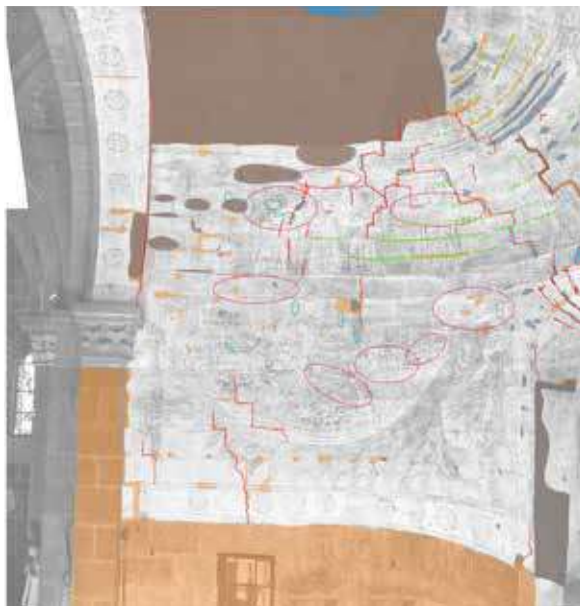
Relevé de toutes les altérations.
