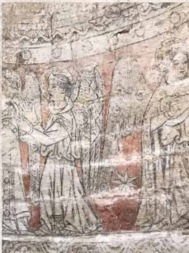
Usures dues au broissage des efflorescences salines.
