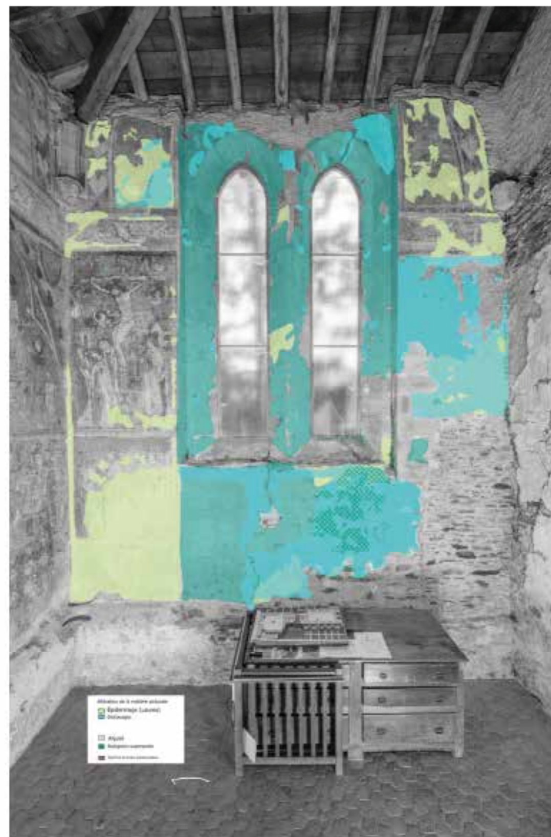
Figure 2. Mur Est. Altérations observées sur les décors peints. Les relevés et photographies ont été effectués par In Situ Conservation. Noter que la croissance d'algues et lichens en formation est localisée dans la partie inférieure de la baie et sur une ligne verticale à l'angle Est-Sud (à droite sur la photo).
