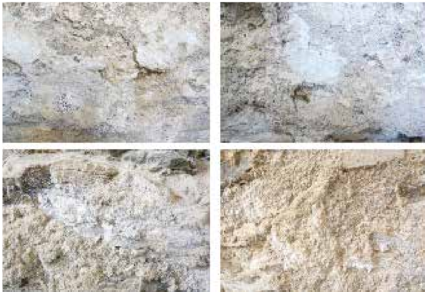
Exemples des altérations de type desquamation, pulvérulence, efflorescences et croûtes indurées relevées dans l'ancien chœur de Sainte-Croix-en-Jarez.
