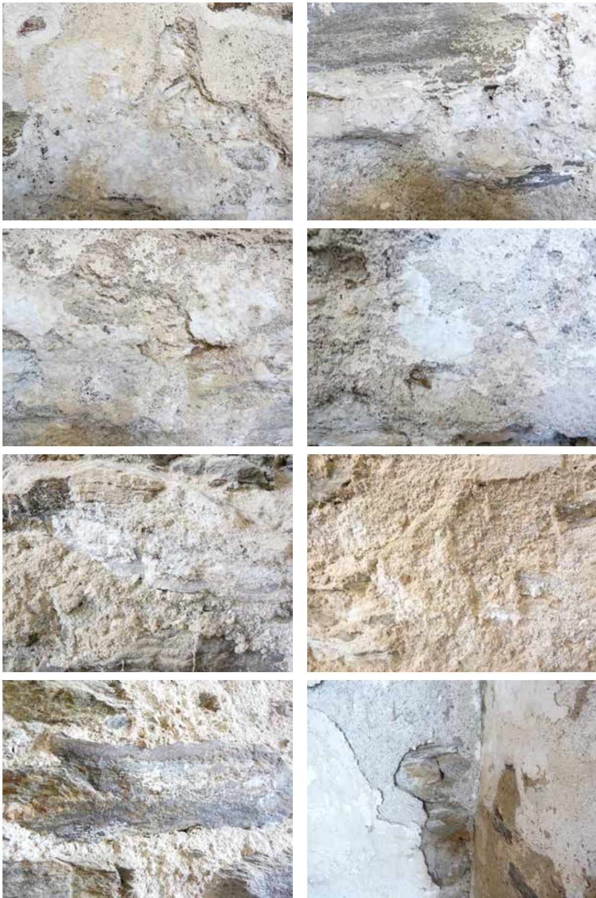
Illustrations des figures d'altérations de type desquamation, pulvérulence, présence d'efflorescences et de croûtes superficielles indurées.
