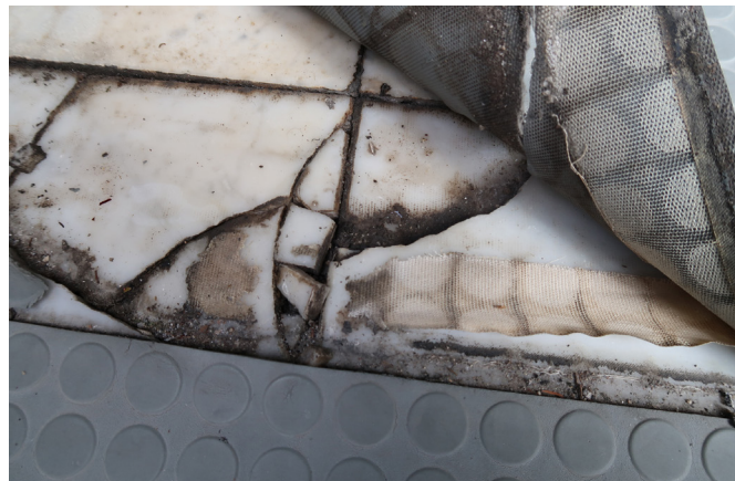
État du marbre sous la bande anti-dérapante
