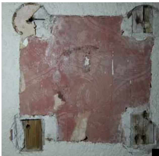
Photographie n°7: Fragment de papier peint visible au niveau du rez-de-chaussée.
