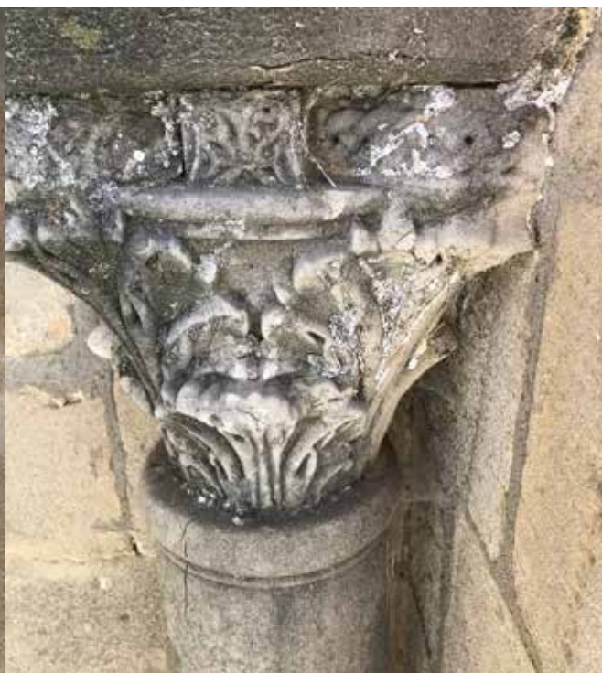
Façade du prieuré Sainte-Agnès, Développement de micro-organismes et érosion de la pierre des chapiteaux.
