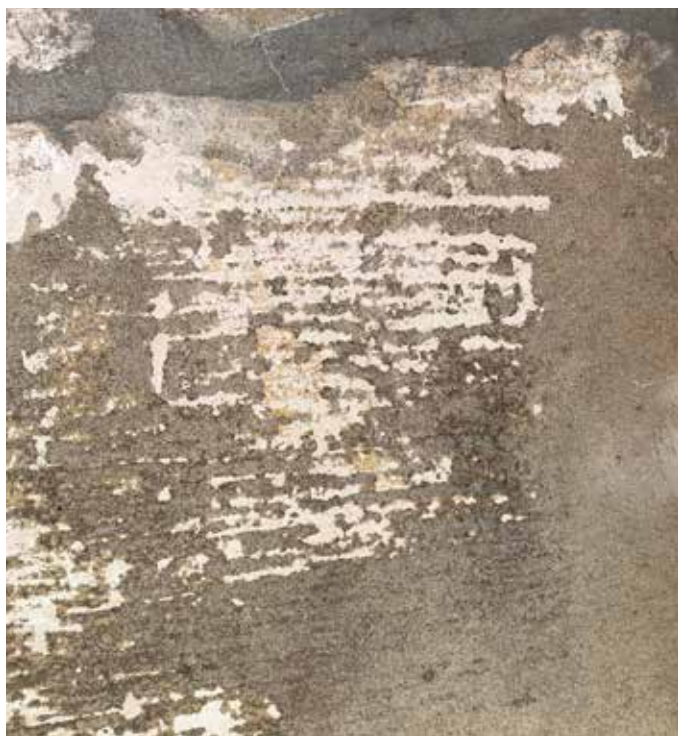
Façade du prieuré Sainte-Agnès, Érosion de la couche picturale.
