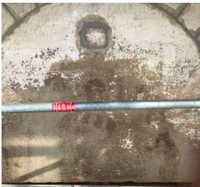
Façade du prieuré Sainte-Agnès, État d'altération des peintures en décembre et avril 2019.
