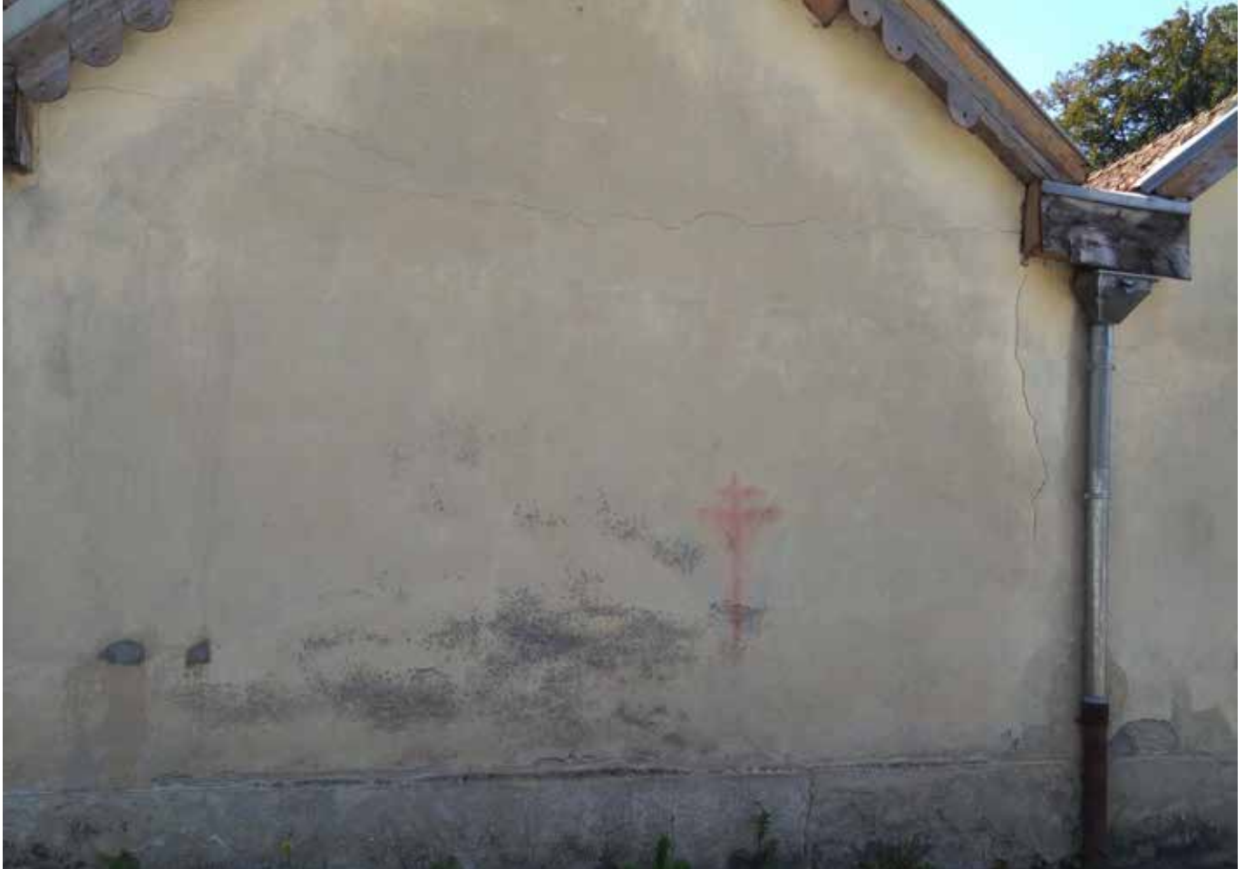
Croix de Lorraine, 220 de la rue du Champs de Mars, avant traitement, Avril 2020.
